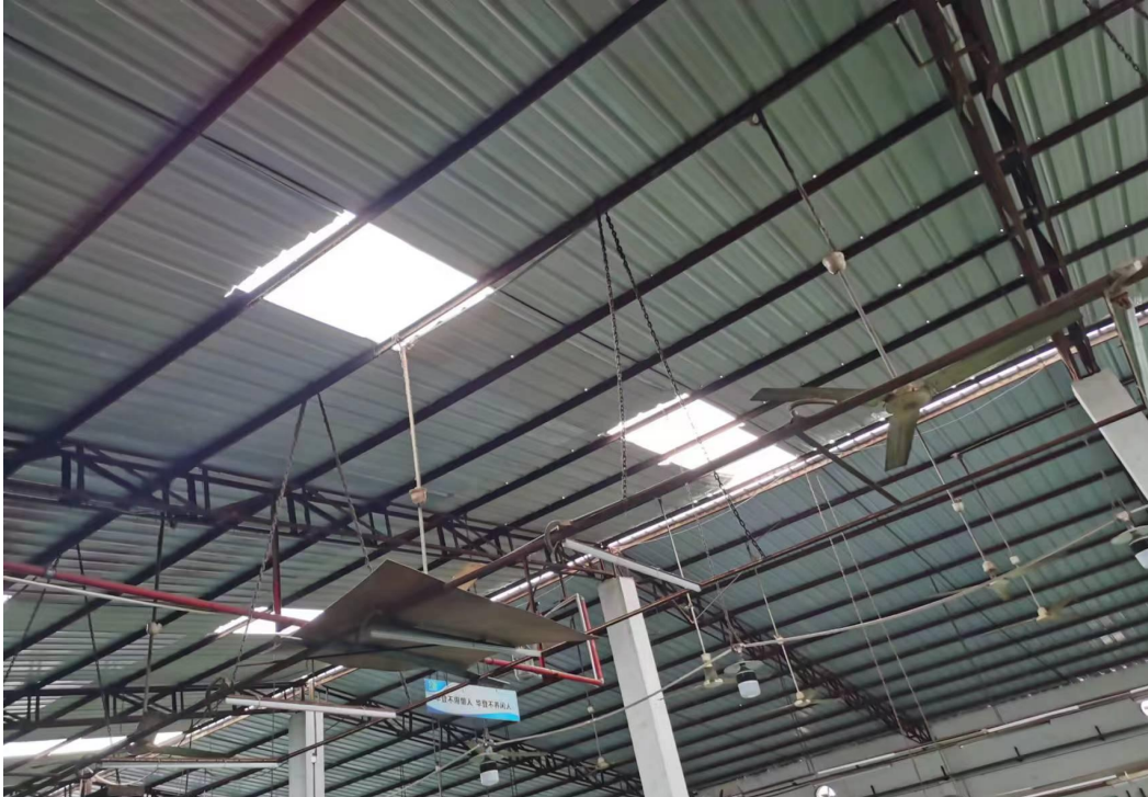
H栋注塑部厂房铁皮屋顶（叶**从此处摔落）
