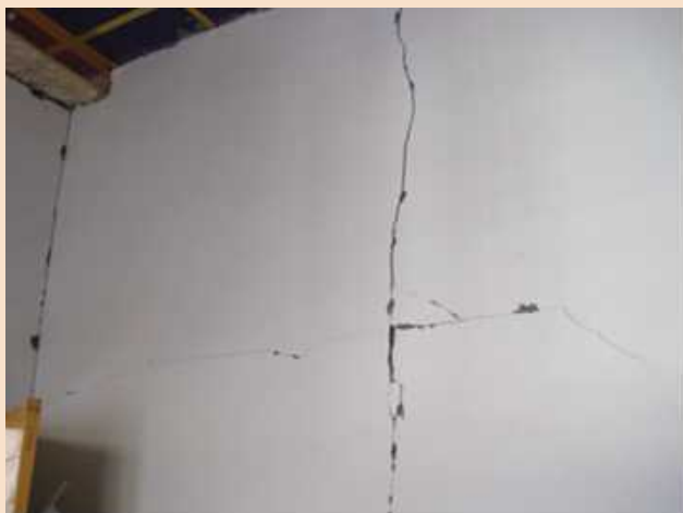
裂缝长度超过墙段高 1/2 的竖向裂缝
