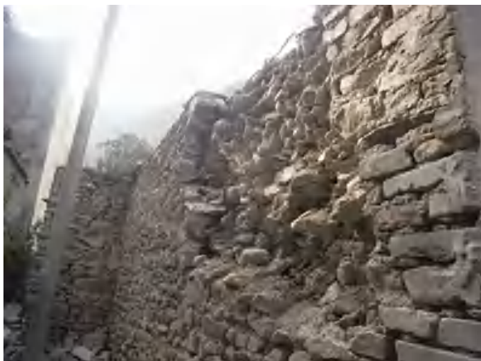
生土墙体歪闪
