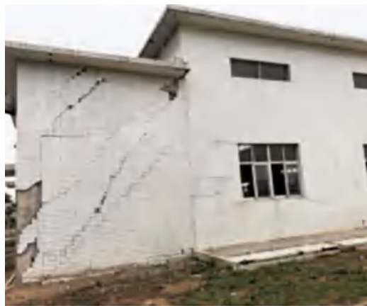
沉降不均匀引起房屋开裂
