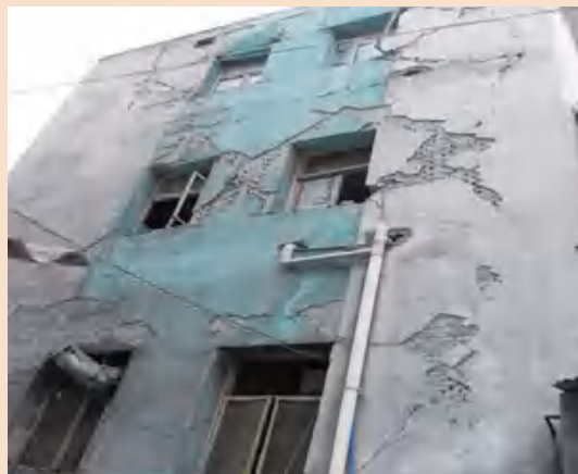
窗上墙体斜裂缝
