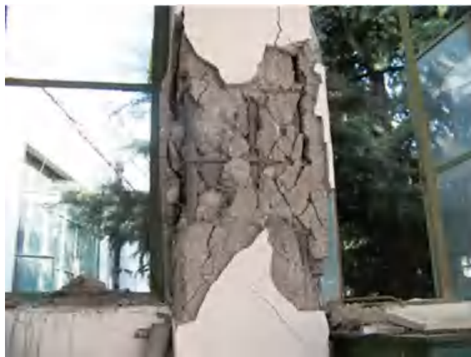
柱出现保护层脱落且具有交叉裂缝
