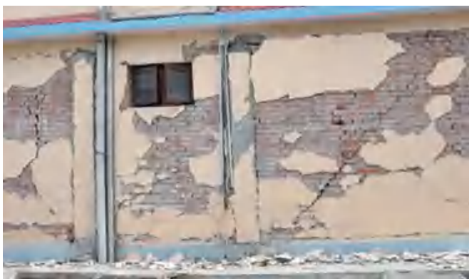
砌体填充墙出现明显斜裂缝
