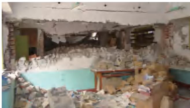
填充墙局部倒塌
