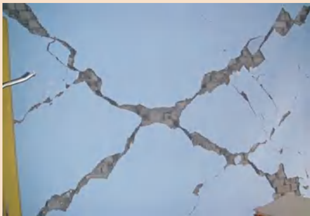
墙体交叉裂缝
